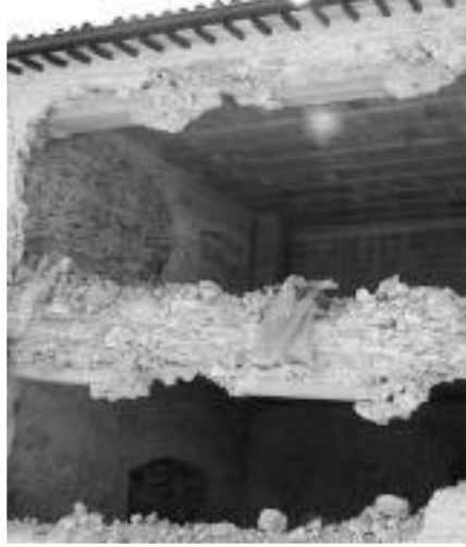
انهيار في الجدران نتيجة وجود فتحات كبيرة
